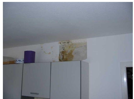
Nach Austausch der Heizung versotteter Kamin
