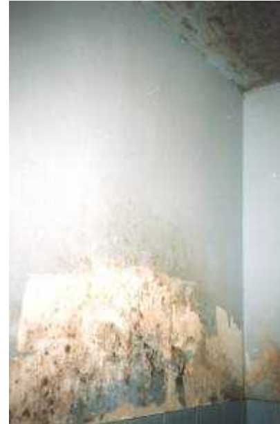
Samsägliche „Badeorgien“ ohne ausreichende Lüftung und Beheizung unter der Woche führten zu diesem Ergebnis
