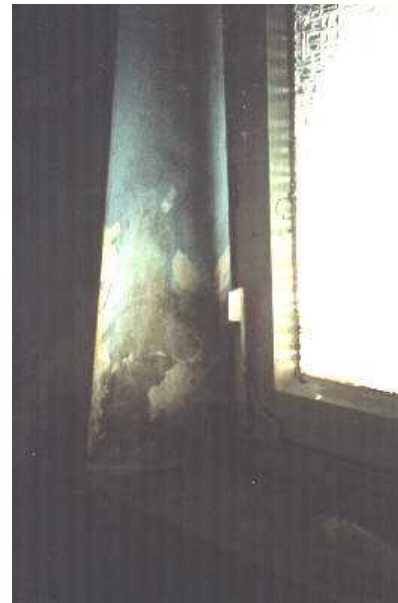
typischer Schimmelbefall durch falsches Lüften
