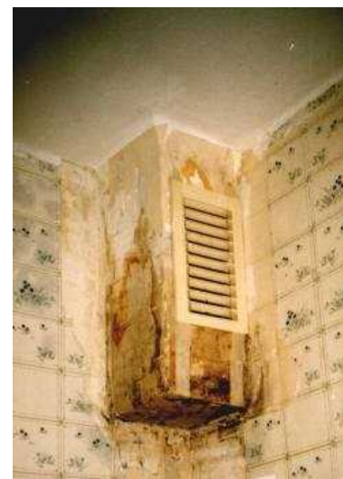
Das falsch ausgeführte Ende eines Lüftungsschachtes
