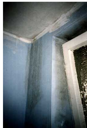
Falsches Lüften führte hier zum extremen Schimmelbefall
